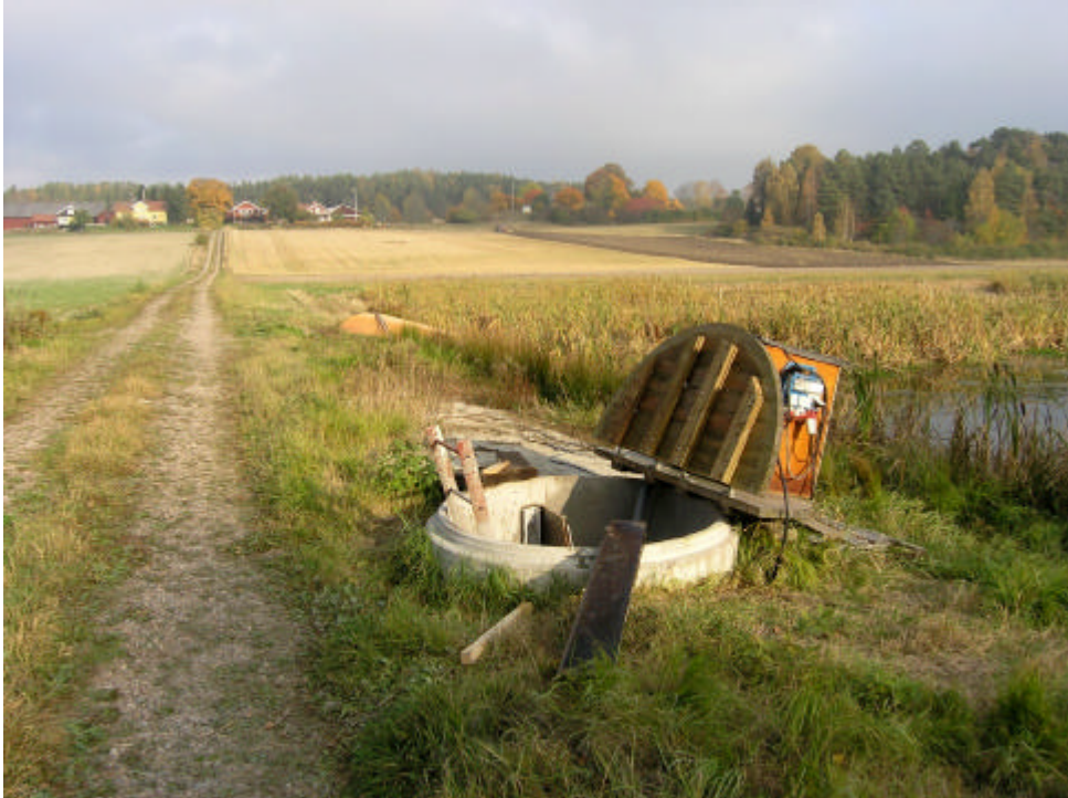
Brunnen vid våtmarkens utlopp där flödesmätning och vattenprovtagare är installerade.
